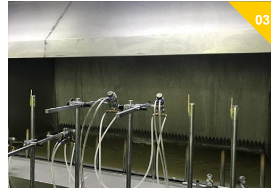
250m, 2 Cabinas Pintura, 2 Hornos.
